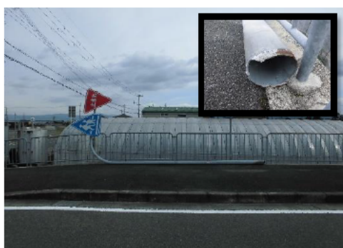
倒壊した大型標識
