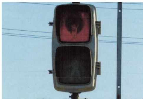
劣化した歩灯器（電球式）
