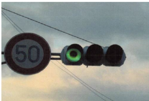
劣化した車灯器（電球式）
